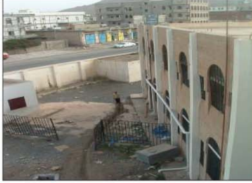
صورة (٤٥، ٤) جزء من نظام الأنابيب لنقل مياه الامطار من سقف المدرسة الى الخزان
