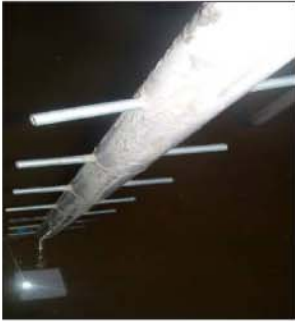
صوره (٥,٤٨) : احد الأعمدة الأربعة بالقرب من فتحة التنظيف تخترقه أنابيب حديد قطر ٤/٣" تستخدم كسلم ولمقياس لارتفاع الماء
